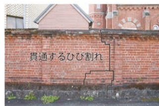
ひび割れた煉瓦塀
