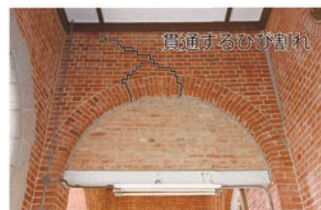
破断した煉瓦アーチ
